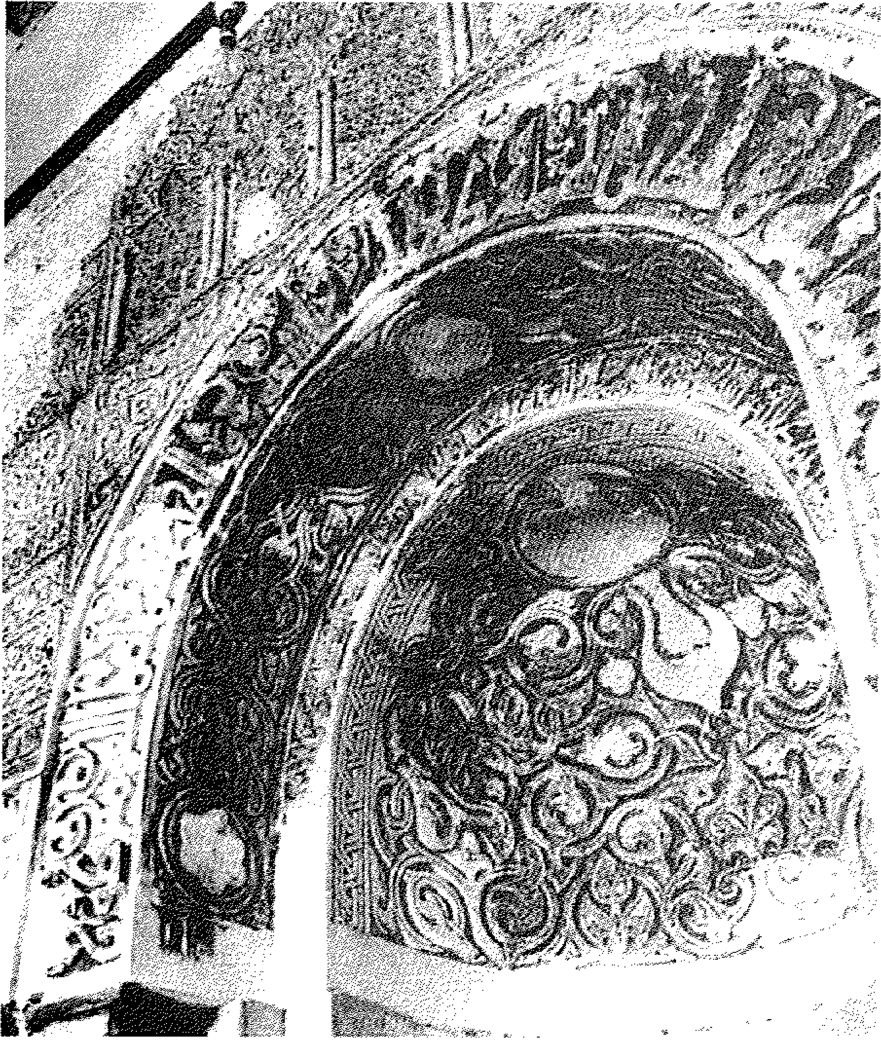
ج - المحراب : زخرفة العقد ونصف القبة (الطاقية) أصلية والبقية تعود إلى فترة متأخرة (أنظر أيضاً لوحة ١١٤) .
