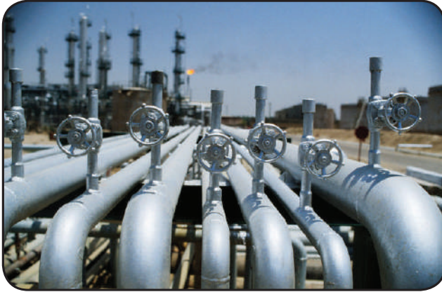
شكل (٢٤) أنابيب نقل النفط
