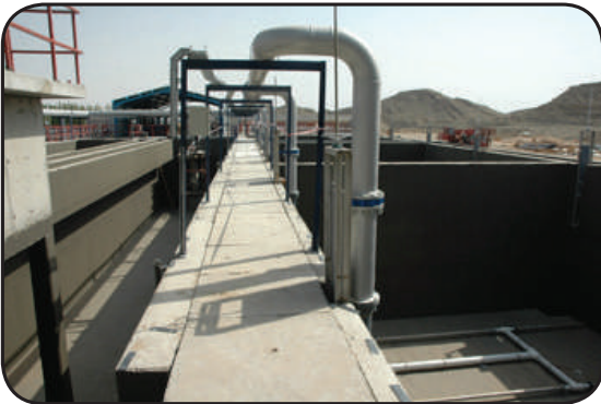
شكل (٢١) محطة الصرف الصحي بالرياض
