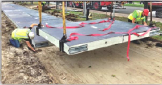
طرق صديقة للبيئة في هولندا- أنشئت طرق للدراجات الهوائية مزودة بالواح شمسية لإتارة الشوارع وأجهزة المرور، وستقل التجربة لشحن السيارات الكهربائية
