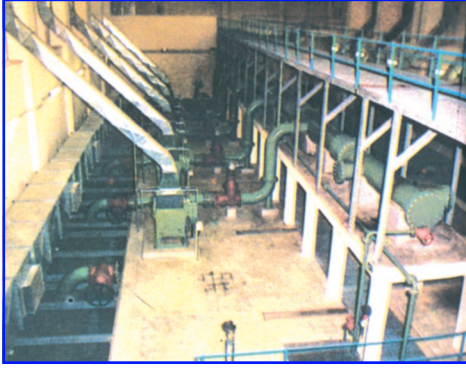
شكل (١١٦) جانب من محطة تنقية المياه
