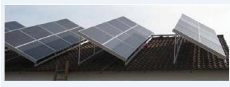
شكل ( ١٣ ) مصفوفة مركبة فوق سطح مبنى
