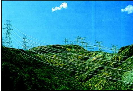
شكل (٩) خطوط نقل القدرة الكهربائية.
