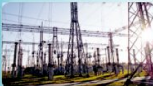
محطة توليد كهرباء شمال القاهرة
