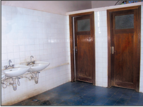
شكل (٧) دورة مياه
