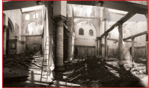
شكل ٤-١١ حريق المسجد الأقصى عام ١٣٨٩هـ/١٩٦٩م
