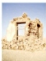
Une maison détruite
